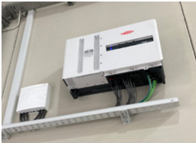
/ Inversor Fronius Tauro Eco anclado a la pared
