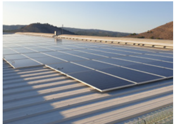
/ Módulos FV sobre el tejado de la empresa Forjados Bernabé SA
